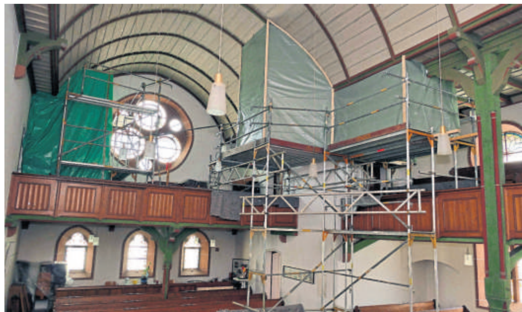
Um den Hausschwamm zu stoppen, sind auch Arbeiten im Inneren des Gotteshauses nötig. F. M.
